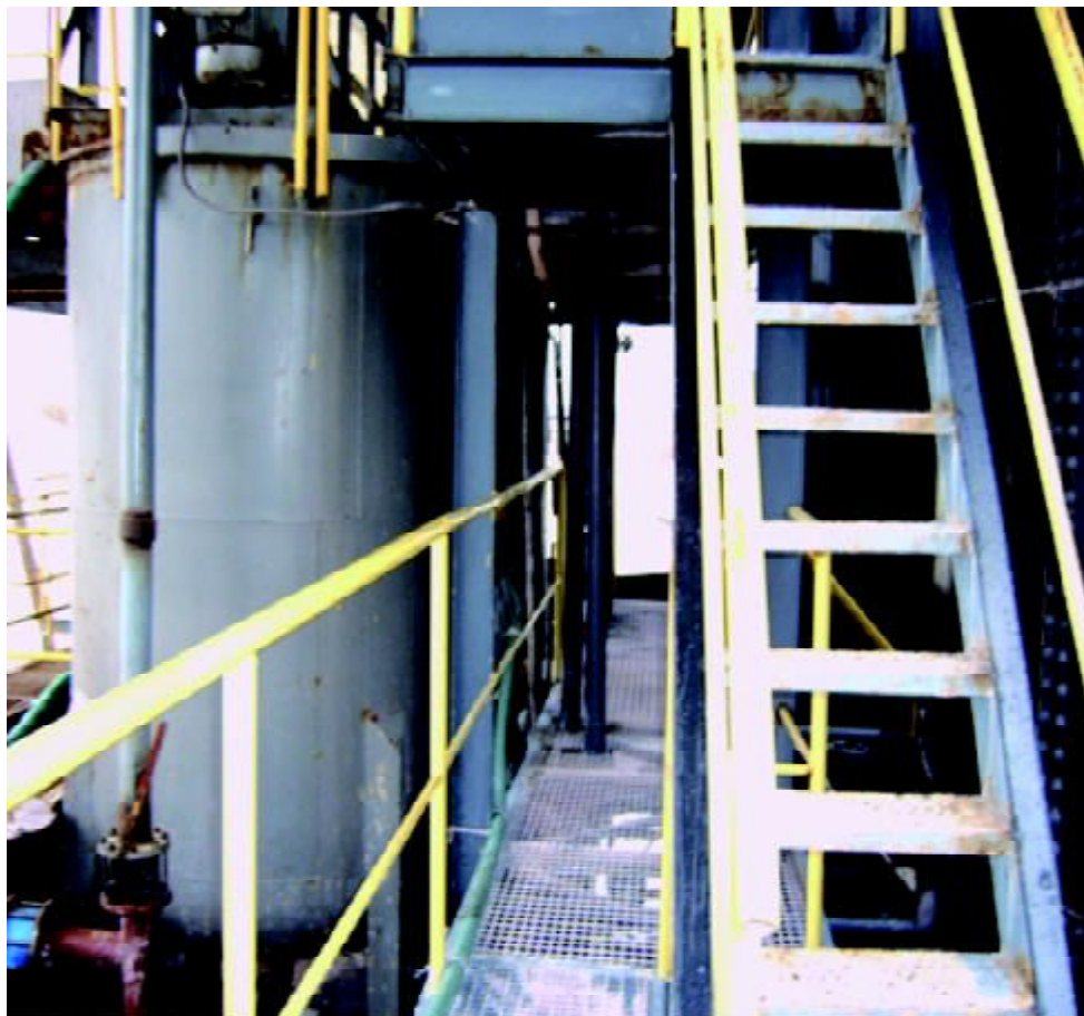
Fot. 2. Fragment instalacji SNP – zbiorniki, mieszalniki
