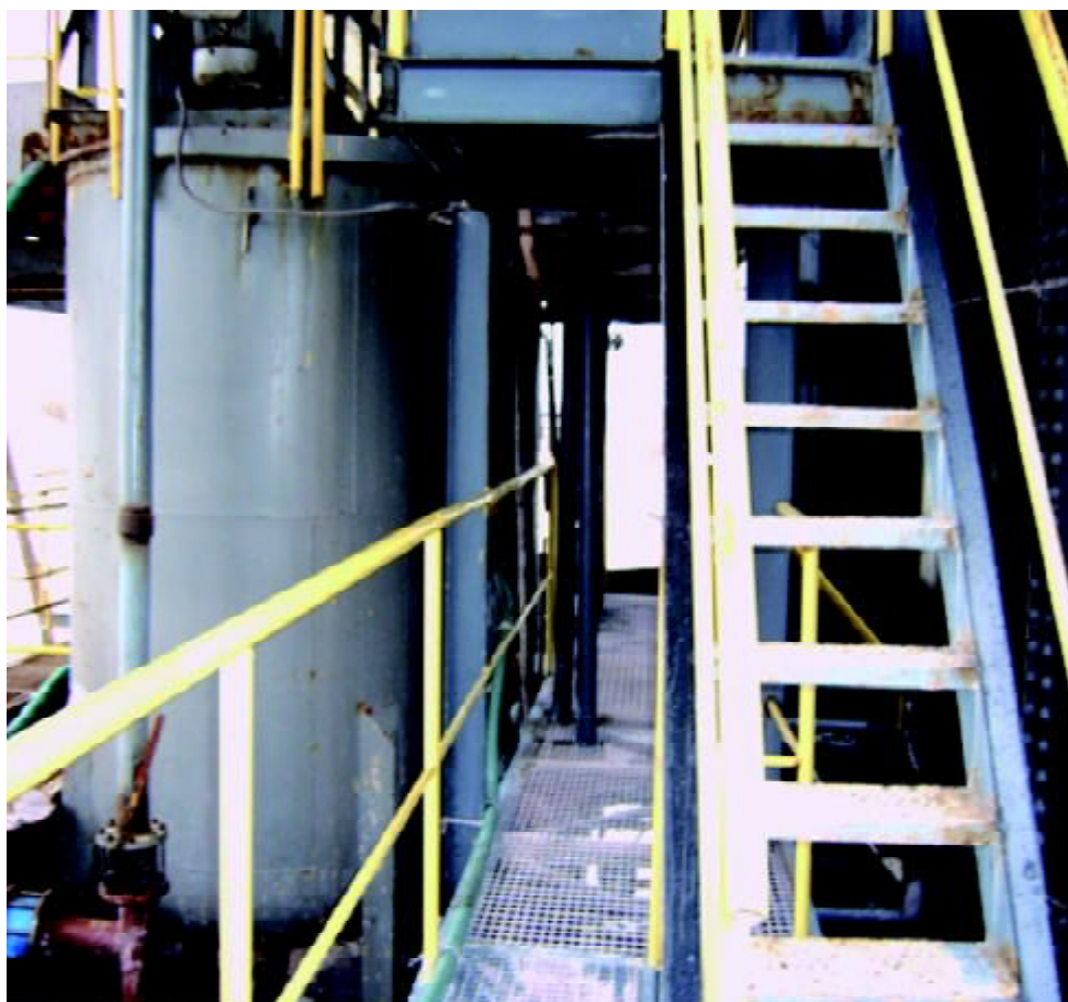
Fot. 2. Fragment instalacji SNP – zbiorniki, mieszalniki
